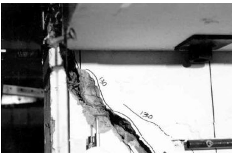
Figura 3.12 Modelo M-0-E6: Detalle del daño en las uniones castillo-dala, en el ciclo final
