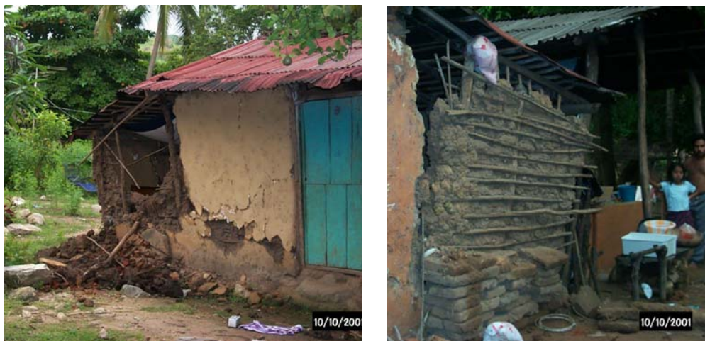
Figura 4.16 Daños de estructuras de bajareque
