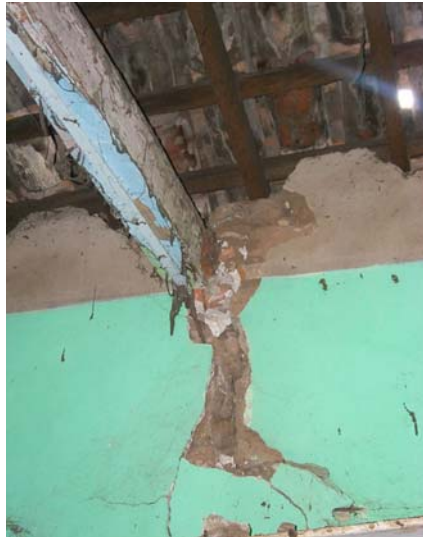
Figura 4.15 Daño local en el apoyo de las vigas del sistema de techo
