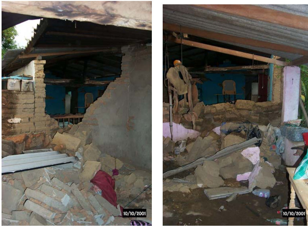
Figura 4.11 Colapsos de muros
