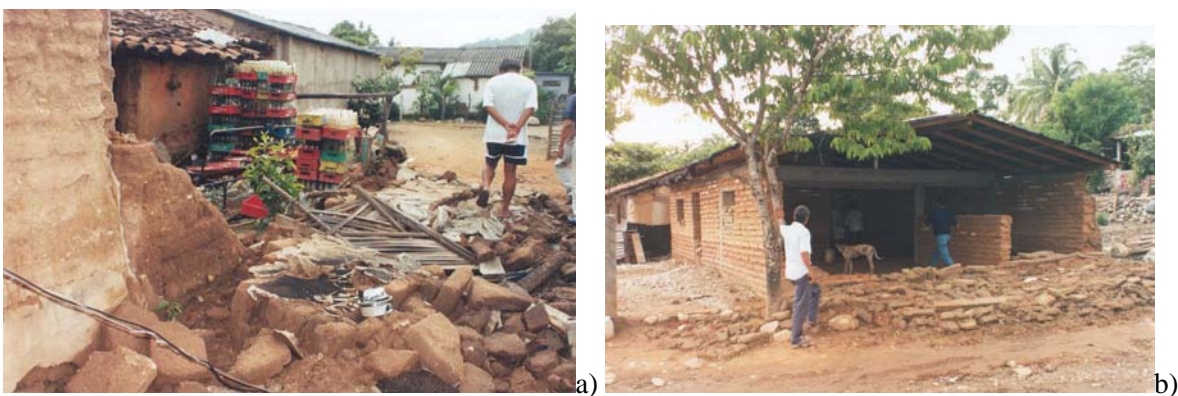
Figura 4.10 Colapsos parciales y totales
