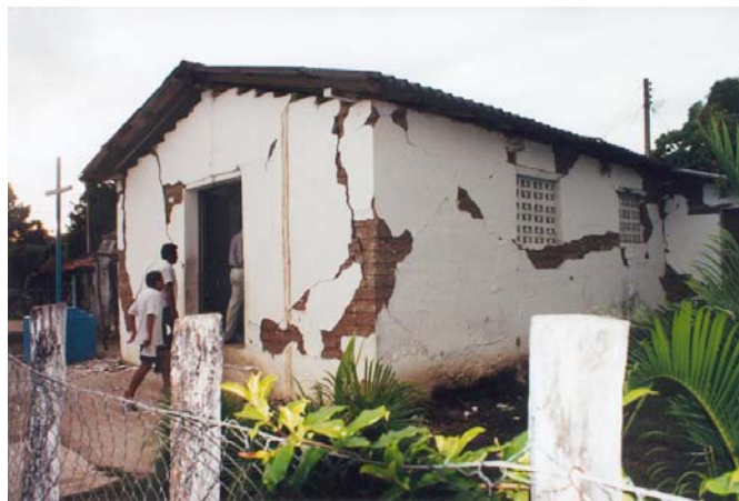
Figura 4.13 Agrietamientos horizontales e inclinados (capilla de Atoyaquillo)
