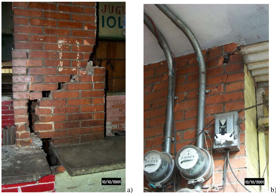
Figura 5.3 Daño en los muros de mampostería: a) Cubos de acceso a la azotea; b) Muro de planta baja
