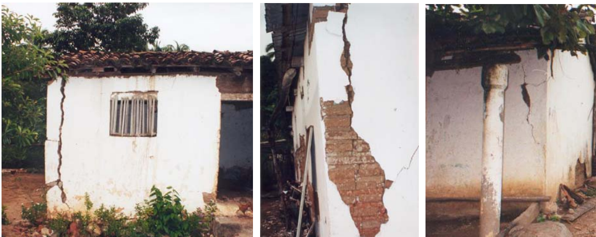
Figura 4.9 Grietas verticales en esquinas
