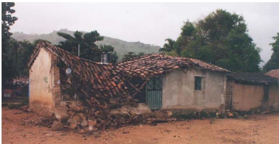
Figura 4.14 Colapso de techos por la caída de muros de soporte
