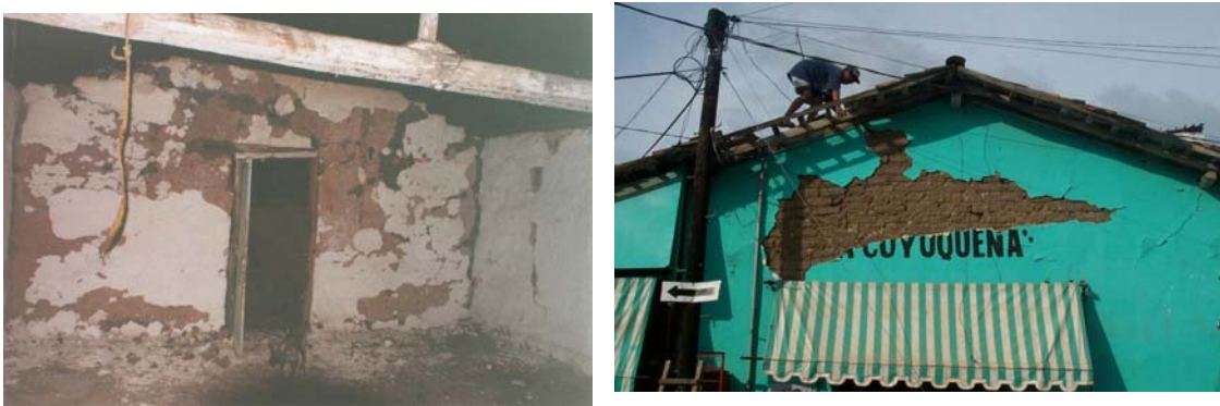
Figura 4.7 Daño en los muros y caída de recubrimiento
