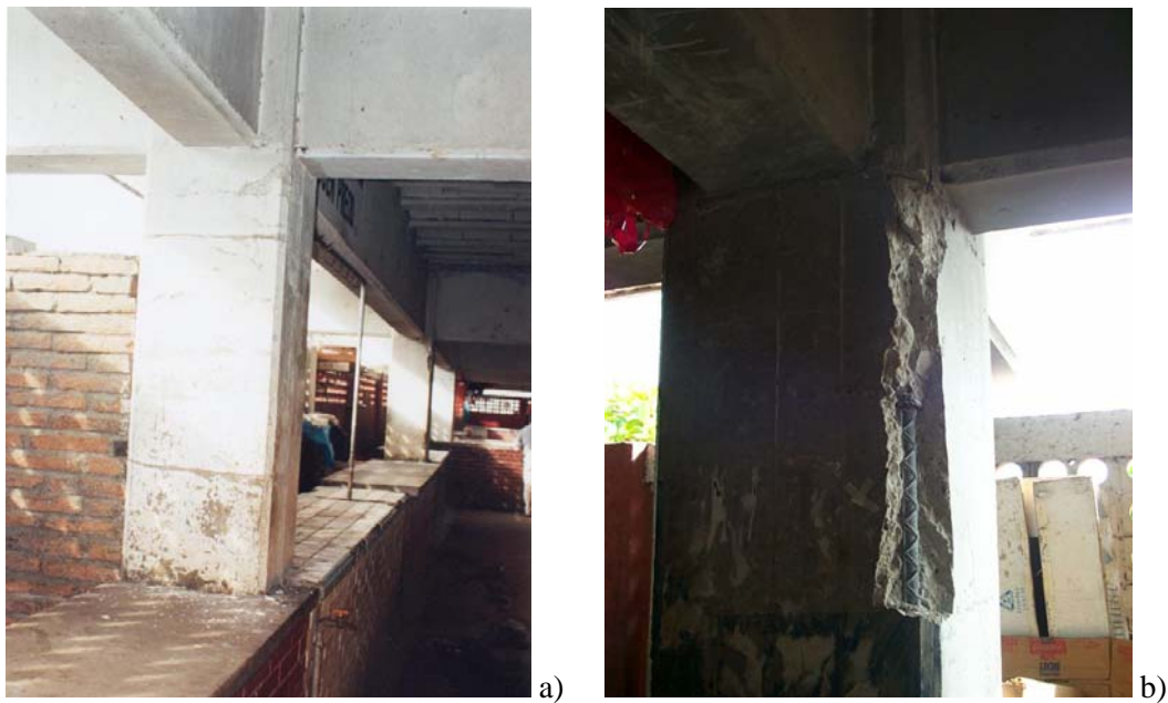
Figura 5.2 a) Columnas cortas en los marcos periféricos del mercado; b) Barra expuesta
