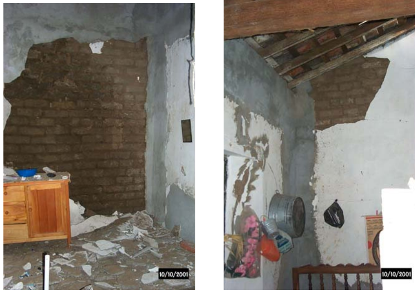
Figura 4.8 Desprendimiento del recubrimiento a) muro con humedad, b) muro seco de la misma vivienda
