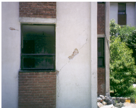
Figura 6.35 - Agrietamientos en muros del piso 1, fachada este del edificio F, una vez retirado el aplastado de yeso
