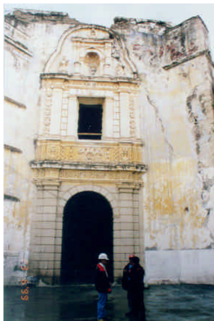
Figura 5.26 - Detalle del daño en la fachada de la Iglesia del Exconvento del Carmen
