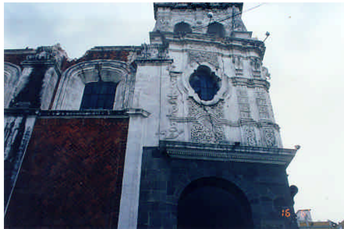
Figura 5.62 - Daño en la torre norte
