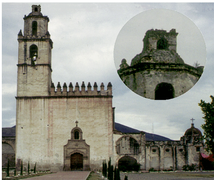
Figura 5.98 - Vista general y detalle del daño en el Exconvento Franciscano
