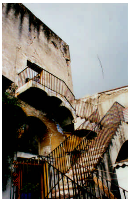
Figura 6.3 - Detalle del daño en muros del exconvento (patio posterior de la vivienda)
