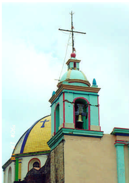
Figura 5.10 - Daño en el campanario de la Iglesia del Barrio de la Preciosa
