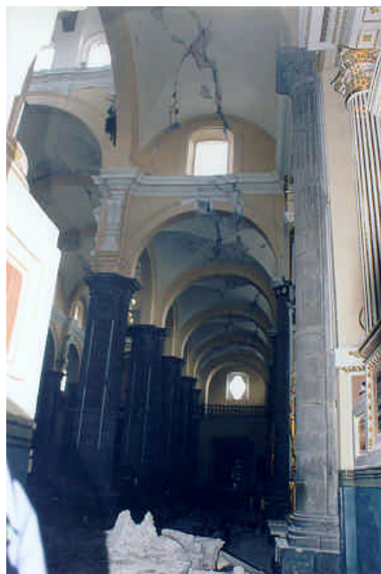
Figura 5.63 - Agrietamientos en bóvedas y arcos de la crujía norte
