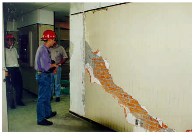
Figura 4.14 - Daño en muros divisorios de mampostería confinada
