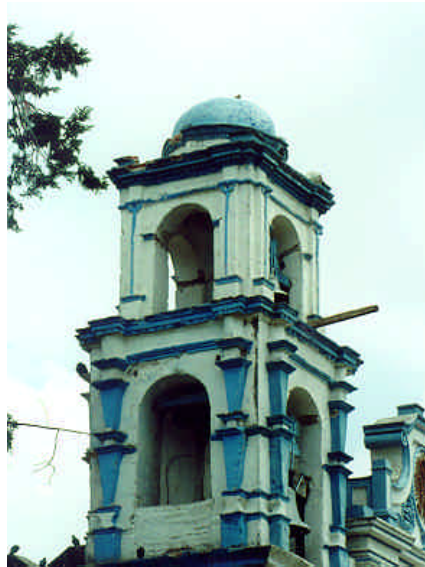
Figura 5.9 - Daño en el campanario de la Iglesia de la Purísima Concepción
