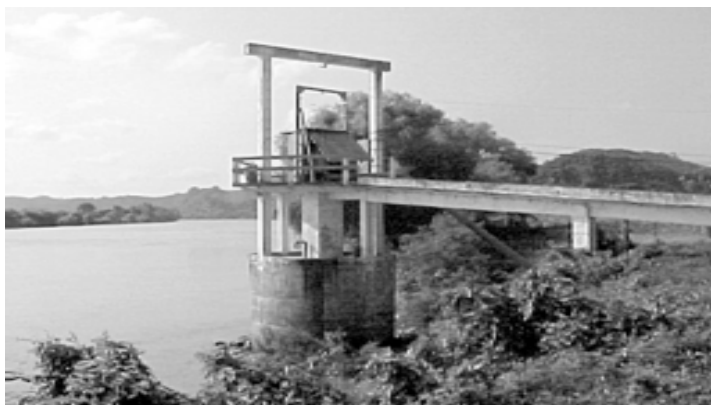
Figura 35 Estación hidrométrica en el río Tecolutla, Veracruz
