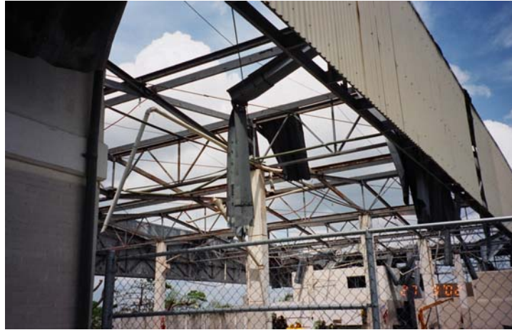
Figura 4.4.a Daños en la lámina de techo de la bodega de almacenamiento de las oficinas regionales de la SCT
