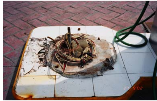
Vista del daño en la estación y detalle de la base de la columna
