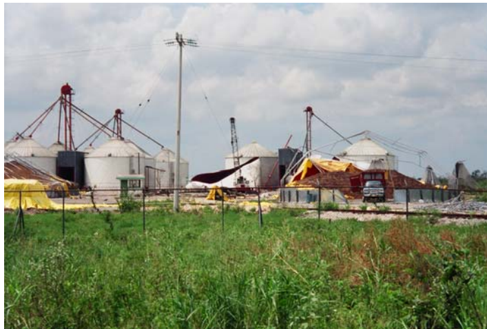
Figura 4.6 Falla de la estructura de un silo para almacenamiento de grano, que se encontraba vacío al momento del impacto del meteoro. La batería de silos se localiza en la carretera entre Mérida y Puerto Progreso
