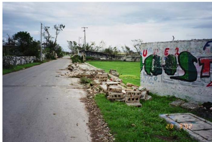
Figura 3.2 Daños y falla en muros de mampostería usados en bardas de colindancia
