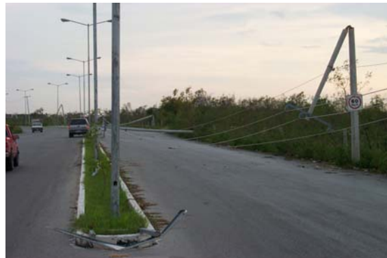
Figura 4.2 Daños observados en los postes de transmisión de energía eléctrica en el estado de Yucatán
