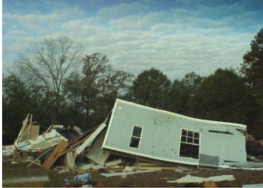
Figura 2.7 Caseta ligera prefabricada en Horizontal County, Alabama, Estados Unidos de América, volcada por los vientos de un tornado (Ray Phillips; Horizontal County, Alabama USA, 11/25/2001; Fotografía tomada de FEMA News Photo)
