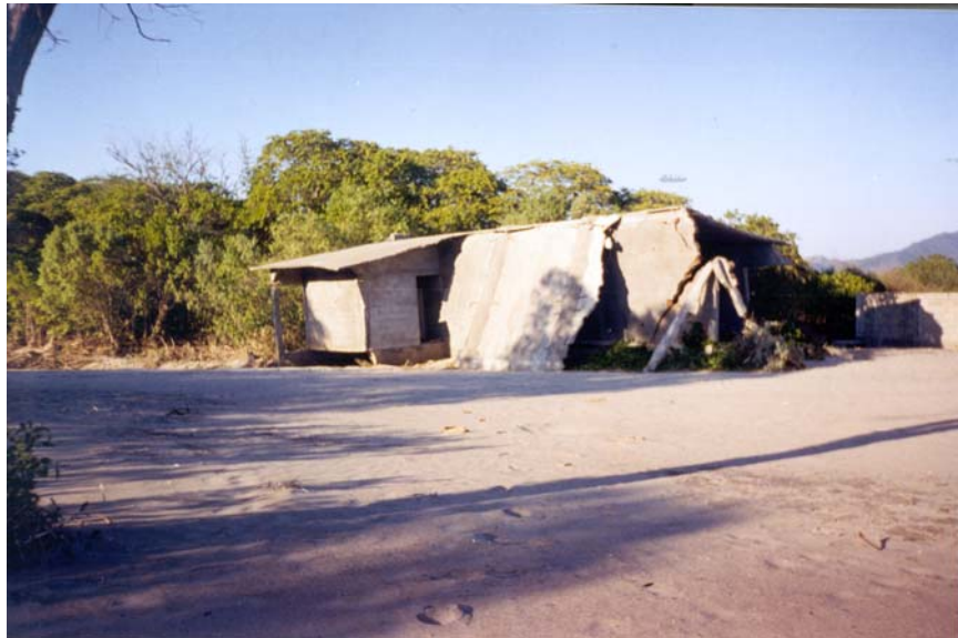
Figura 2.6 Falla de una estructura de mampostería confinada por efecto del viento (H. Toledo; Oaxaca, México, 1999)
