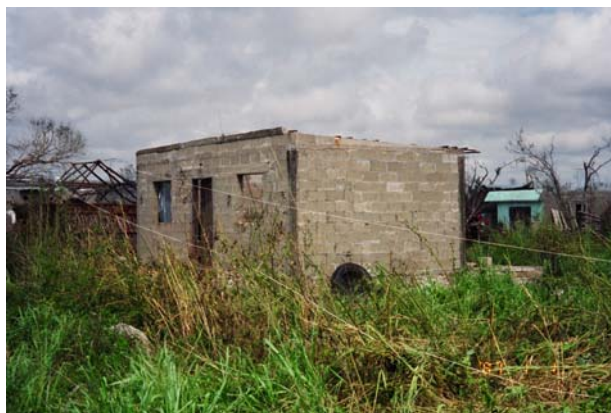
Figura 4.7 Daño en vivienda de mampostería confinada con material precario en techo
