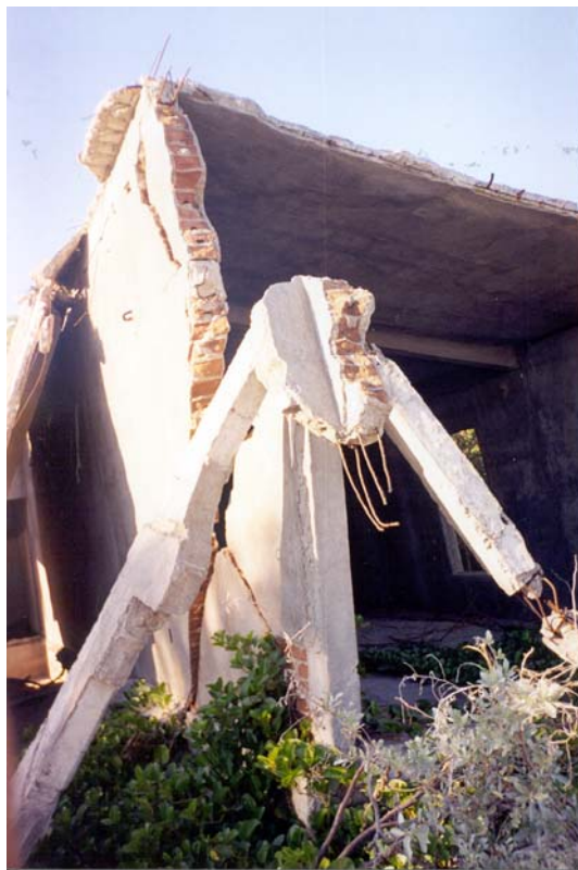
Figura 5.2 Falla de una estructura de mampostería confinada por efecto de viento (H. Toledo Huracán Pauline, Oaxaca, México, 1999)
