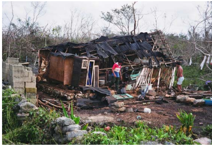
Figura 4.9 Falla de vivienda con tipología de la región, constituida a base de material precario en muros y techos
