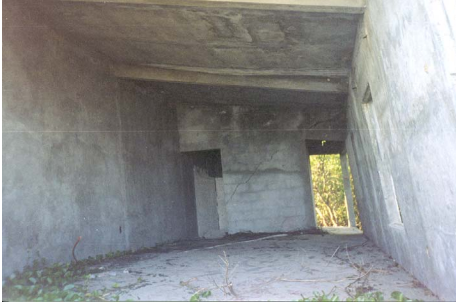
Figura 2.8 Falla por flexión del muro o por giro de la cimentación en una estructura de mampostería confinada (H. Toledo; Huracán Pauline, Oaxaca, México, 1999)
