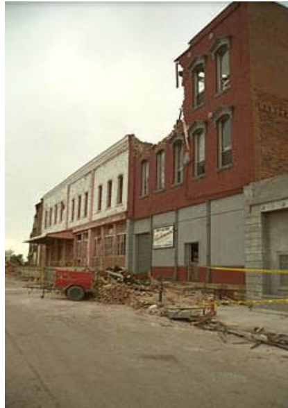
Figura 3.1 Daños en muros de mampostería por efecto de viento (Huracán Andrew, Florida, USA, 08/24/1992; Fotografía tomada de FEMA News Photo)
