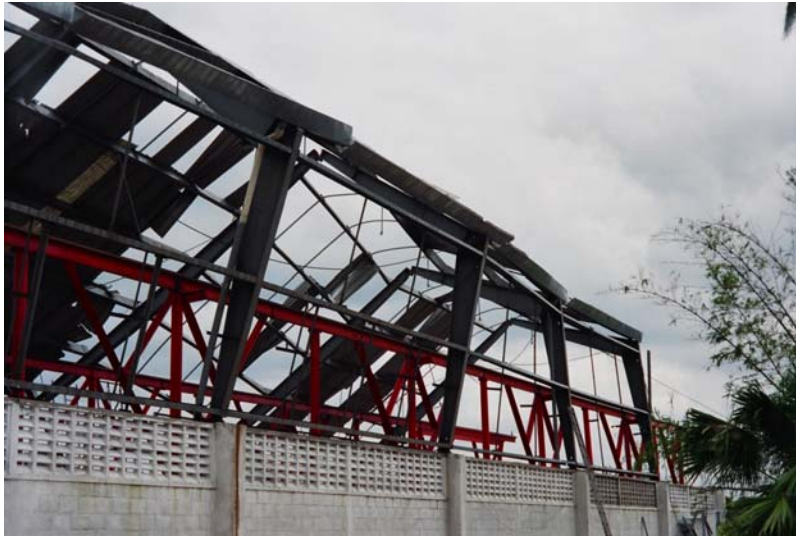
Figura 4.13 Comportamiento inadecuado de una estructura tipo nave industrial por corrosión debido a intemperismo de los tornillos de unión en las vigas de los marcos
