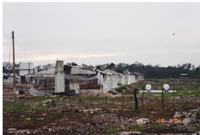
Figura 4.4.b Daños típicos observados en las bodegas de las granjas avícolas de la región
