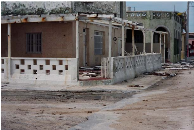
Figura 5.5 Edificación con cubierta de techo a base de teja, ante la incidencia de vientos fuertes la teja se desprende y es levantada, dejando únicamente a la estructura de soporte
