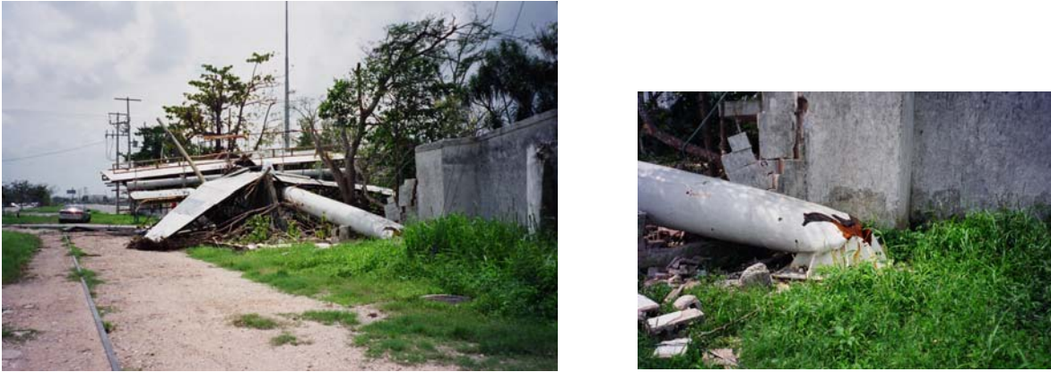
Figura 4.5 Falla de estructura con un anuncio espectacular en la carretera entre Mérida y Puerto Progreso
