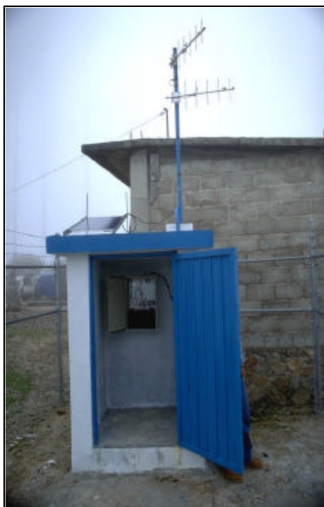
Figura 5.13 Estación repetidora Mozotal
