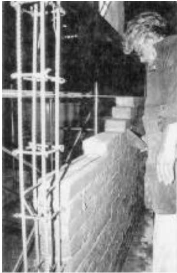
a) Colocación del tabique y detalle del anclaje del refuerzo horizontal de M4
