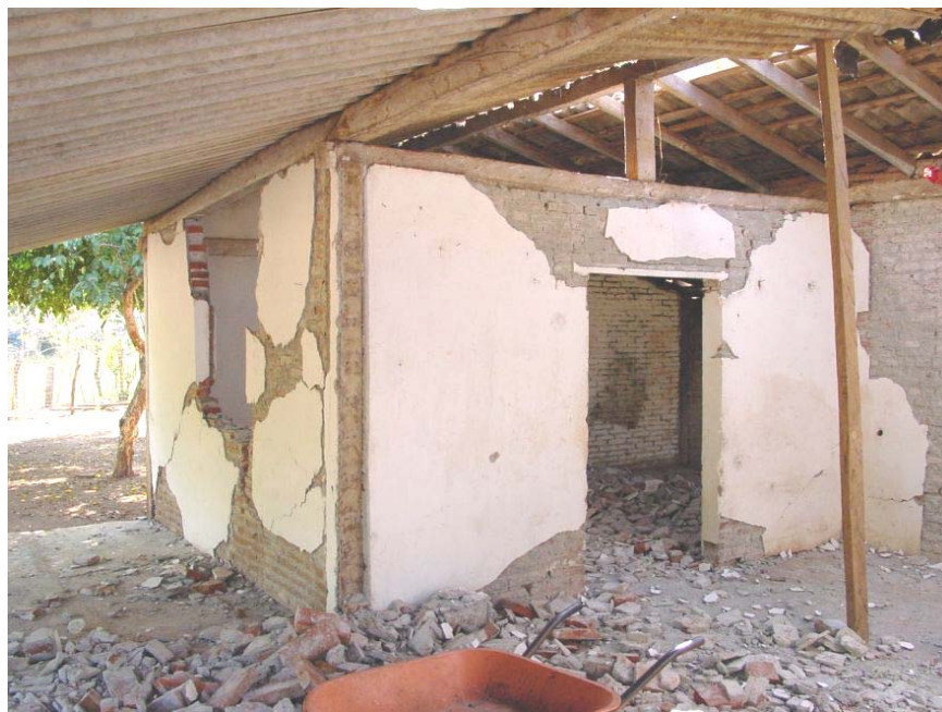
Figura 7.117 Daños en viviendas de mampostería simple
