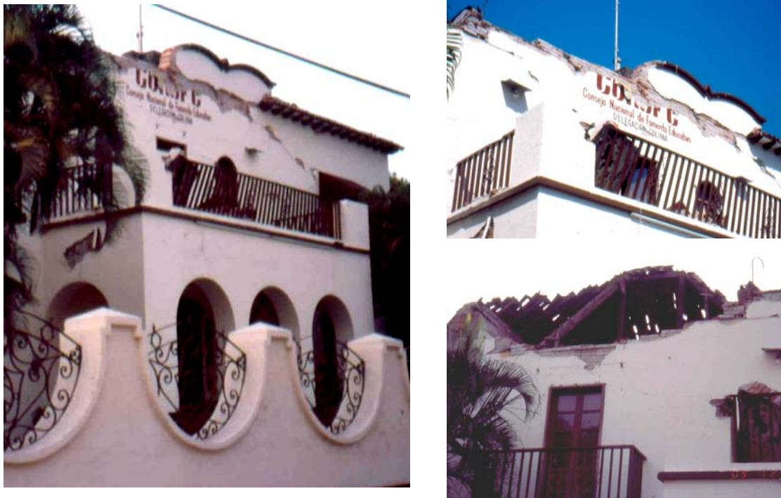
Figura 8.5 Daños en el edificio del CONAFE
