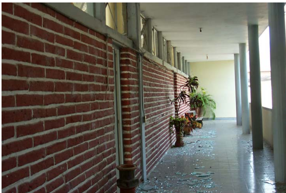
Figura 8.18 Rotura de vidrios en un edificio escolar
