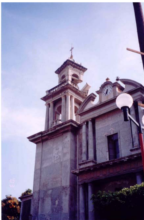
Figura 10.14 Vista del daño en el campanario norte
