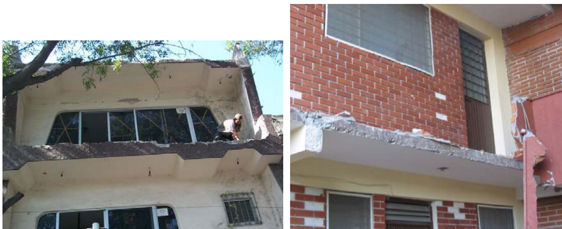
Figura 7.133 Pretils como barandal en balcones y pasillos. En la foto de la derecha el pretil tenía cadena horizontal, pero el castillo estaba mal anclado en su base
