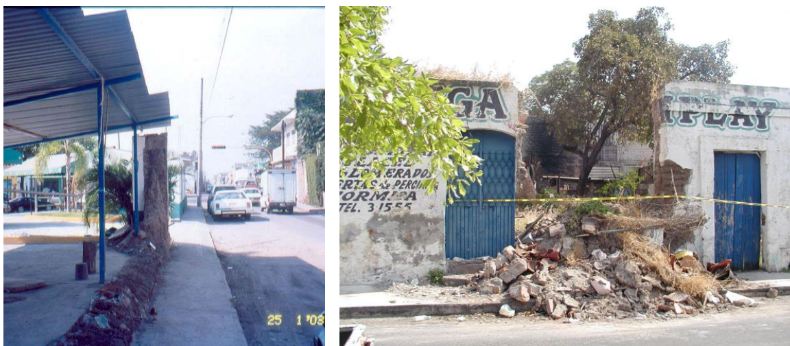
Figura 7.122 Colapso de bardas de adobe
