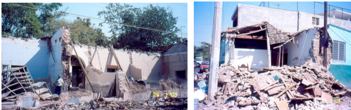
Figura 7.11 Colapso de viviendas de adobe
