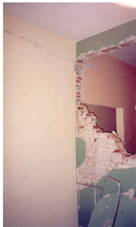
Figura 7.51 Daño en muros interiores de la vivienda 10
