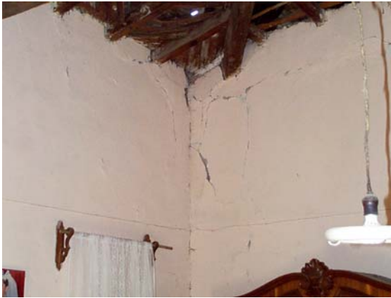
Figura 7.89 Agrietamiento en la intersección de muros
