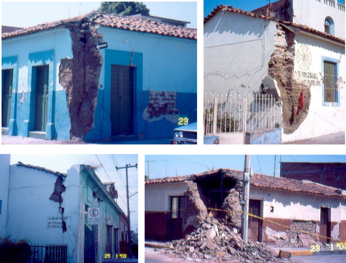
Figura 7.8 Grietas verticales y colapso de esquinas
