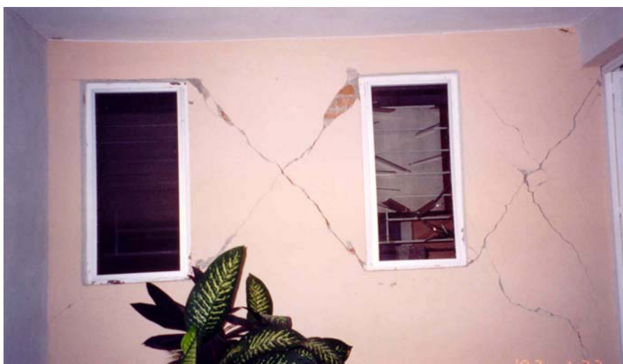
Figura 7.16 Daño típico en muros de mampostería confinada
