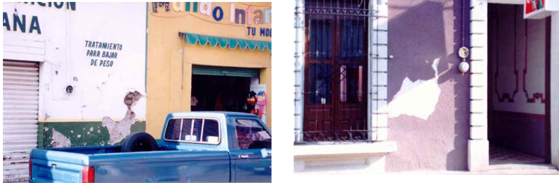
Figura 7. 93 Caída del recubrimiento en algunos muros de mampostería simple (de adobe y arcilla recocida sin refuerzo)
