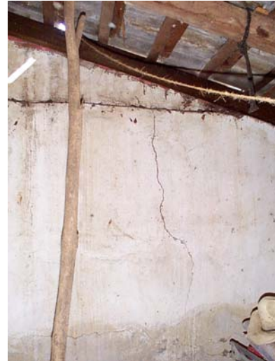
Figura 7.79 Agrietamiento vertical en muros cabeceros
