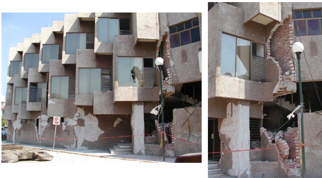
Figura 12.8 Fachada principal y detalle del daño
