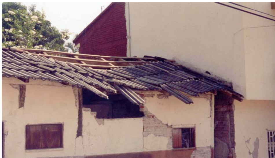
Figura 7.52 Vivienda número 3 con daño tipo III
