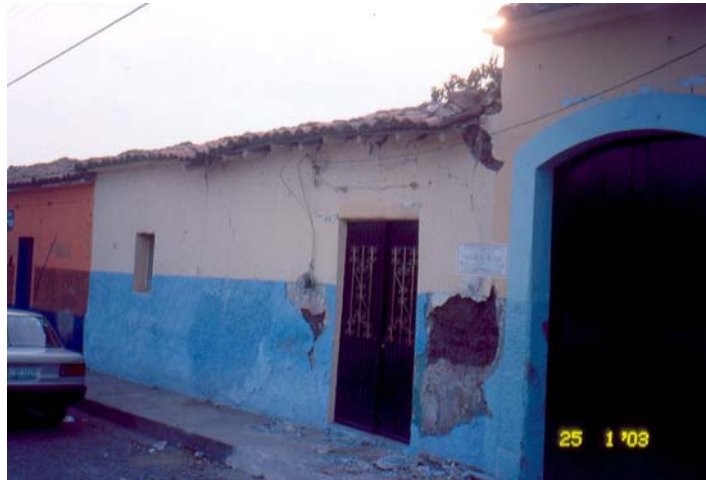
Figura 7.57 Daño ligero en vivienda de adobe
