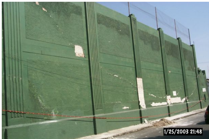
Figura 7.125 Agrietamiento en el muro de un frontón
