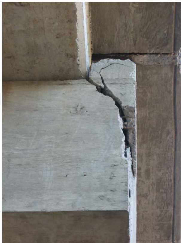
Figura 6.6 Daño en tope del puente “Manzanillo”
