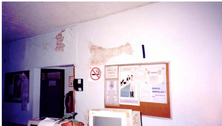
Figura 11.5 Ejemplo del daño en muros divisorios
