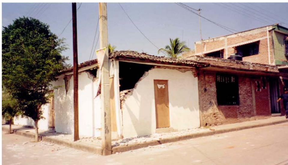
Figura 7.53 Vivienda número 13 con daño tipo III
