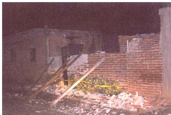
Figura 7.99 Caída de bardas de mampostería simple
