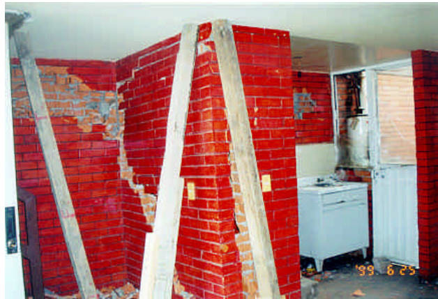
Figura 6.19 - Daño en el muro interior del eje 2
