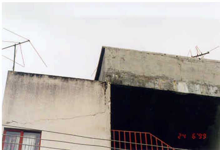
Figura 6.8 - Daño en pisos superiores
