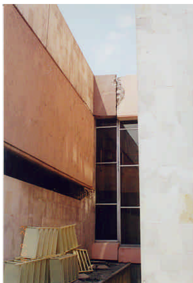
Figura 4.9 - Aplastamiento en juntas constructivas
