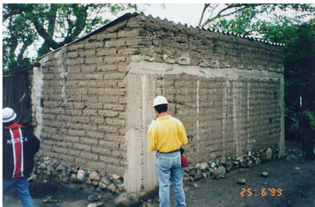
Figura 6.43 - Vivienda de adobe dañada
