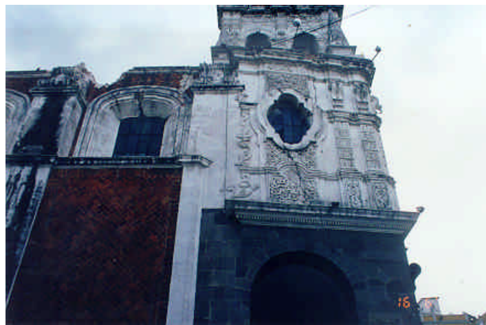
Figura 5.62 - Daño en la torre norte
