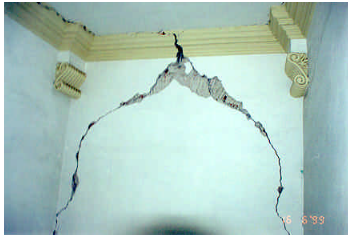
Figura 5.57 - Agrietamiento que sigue la traza de un arco relleno con muro de mampostería
