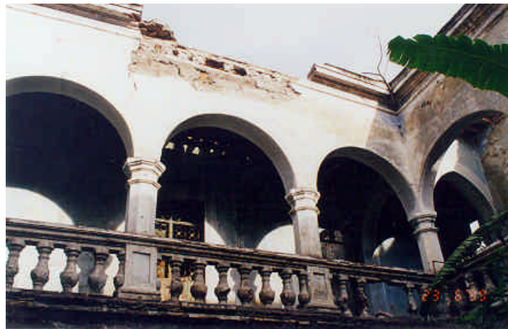
Figura 6.2 - Detalle del estado de abandono de la vivienda Nicolás Bravo
