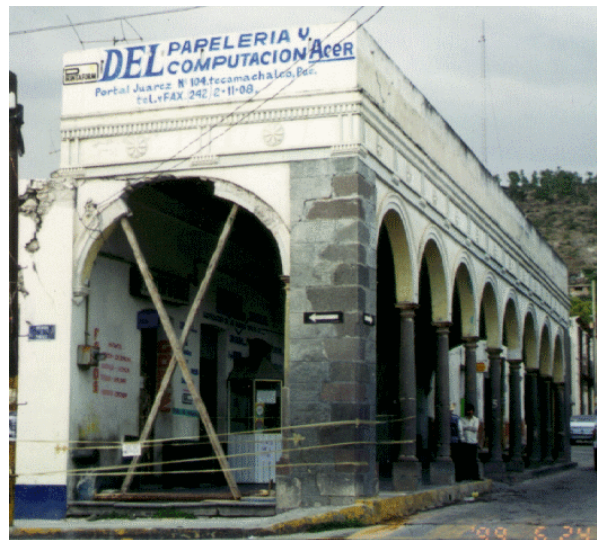
Figura 8.15 - Falla en arco de portales
