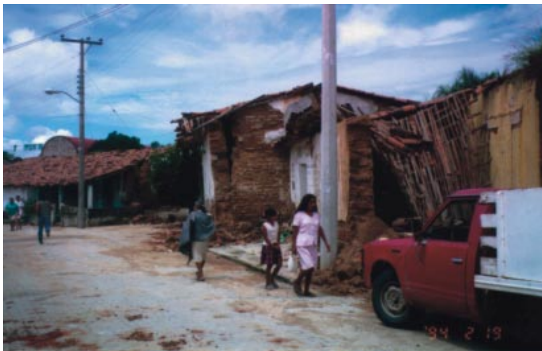
Figura 27. Daños típicos en construcciones de adobe
