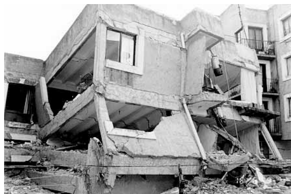
Figura 27 - Daños por defectos constructivos y efectos de sitio en un conjunto habitacional de la ciudad de Puebla (Foto: Alcocer et al., 1999)
