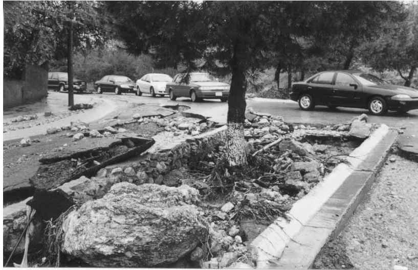
Fotografía 1.2 Daños en infraestructura urbana
