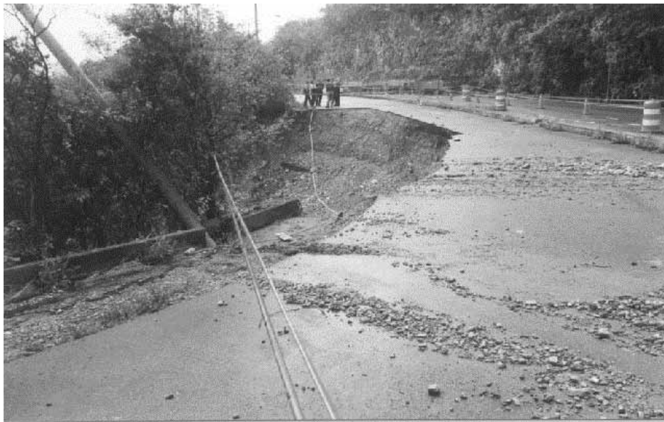
A.10 Otra vista de la falla del talud de la Av. San Ángel.
