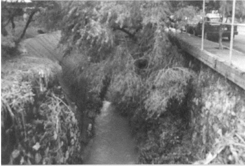
A.5 Reducción de la sección transversal de arroyo Chupaderos, aguas arriba de la zona afectada en la colonia Las Brisas.
