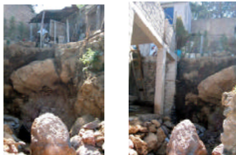
Los cortes en las laderas del cerro aumentan los problemas de inestabilidad local
