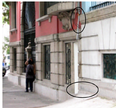
Asentamiento diferencial entre edificios vecinos.
