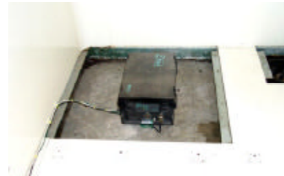
Nuevo adquisidor ETNA, estación Roma-B
