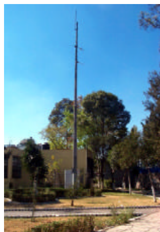
Estación Zaragoza, antena de comunicación
