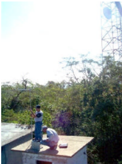
Pruebas de comunicación para definir los sitios donde se instalarán estaciones de medición de lluvia del Sistema de Alerta Hidrometeorológica del río Sabinal, en la ciudad de Tuxtla Gutiérrez, Chiapas.
