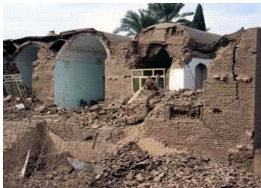
Daños severos en escuelas y construcciones con muros y techos de adobe. Bam, Irán.
