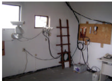
Equipos instalados para el control de la cámara
