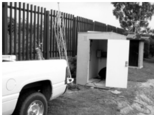
Instalación de estación sísmica en el CENAPRED
