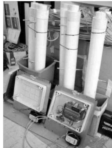
Aspectos de la fabricación de las estaciones de medición de nivel
