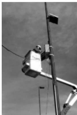
Aspectos de una de las estaciones de nivel del SAH del río Sabinal
