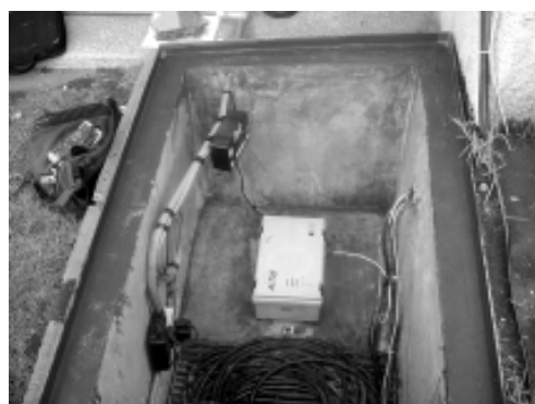
Estación sísmica del IMP, Mantenimiento
