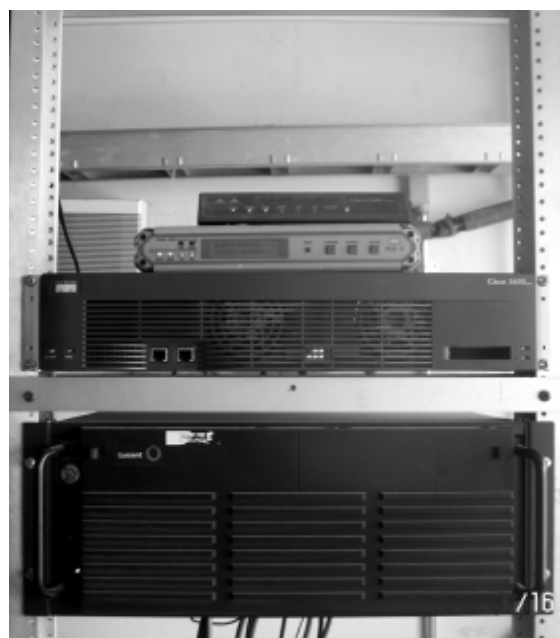
Equipos para enlaces E1 con SEGOB y con la UNAM
