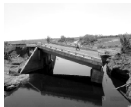
Daños causados por el huracán "Lane" en Sinaloa, foto superior, camiones pesados arrastrados por los fuertes vientos en San Lorenzo, Culiacán. foto inferior puente colapsado en el km 129 de la Maxipista.
