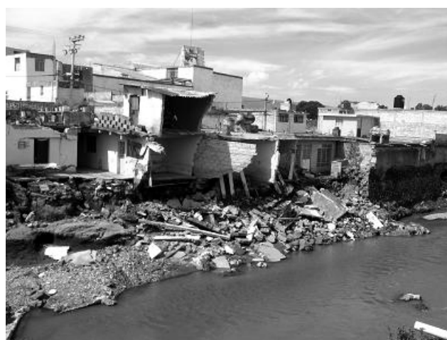
Daños en vivienda en Tulancingo a Causa de Dean
