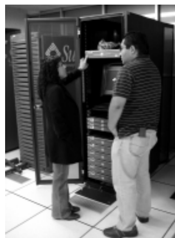
Instalación del servidor del estado de Veracruz para el proyecto del Atlas Mesoamericano de Peligros.
